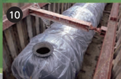
10 防震蓄水槽 为预防地震等灾害造成断水而储备饮用水。
