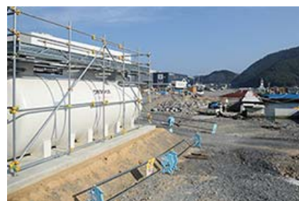
净化槽（对尚未修复下水道的地区及临时住宅地区进行排水处理）
