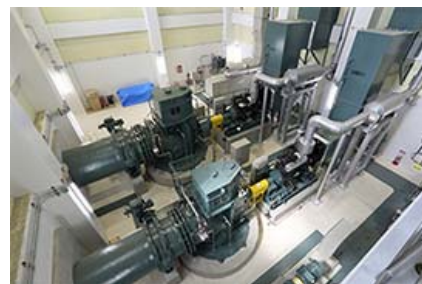
水泵（用于紧急排水，防止因大雨和大浪造成的浸水）
