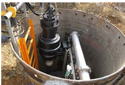
管井水泵（污水加压输送）
