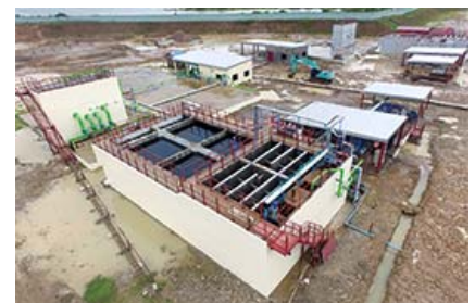
迪拉瓦工业园区 A区净水厂 ( 缅甸 )
