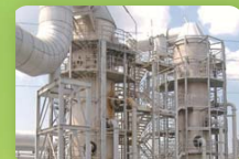
排烟脱硫、排烟脱硝装置
