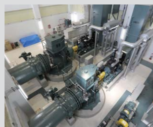
水泵 可用于紧急排水，排除因大雨及涨潮引起的浸水。
