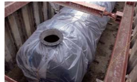
10 耐震蓄水槽 为预防地震等灾害造成断水而储备饮用水。
