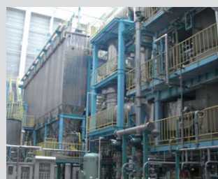
水处理设施 对生活污水及工业废水等进行净化处理。
