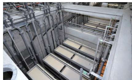
液膜组件 用于对生活污水及工业废水等进行净化的处理设施。
