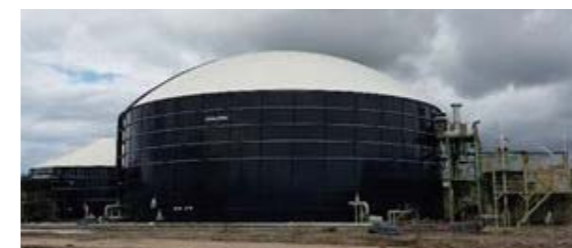
马来西亚1号机(BBC Biogas公司用)膜型沼气发酵设备全貌
